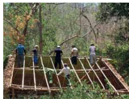
Mit vereinten Kräften geht es auf Ometepe an den gemeinsamen Bau eines Hauses. Foto: Regine Stein
